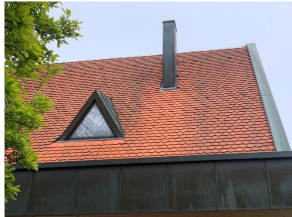
Abb. 3: Blick auf Dach und Fenstergaube ohne Einflugmöglichkeiten, Spalten o.ä.
