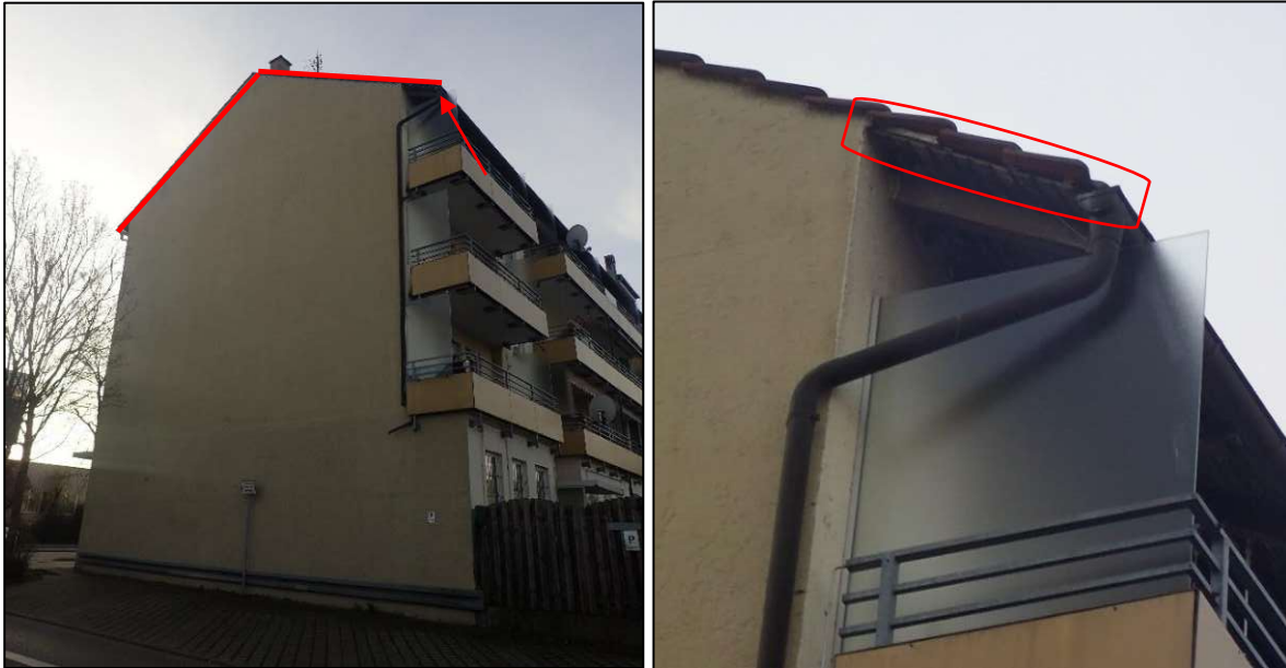
Abbildung 12: Gebäude „Stuttgarter Straße 82B“ - Spalten im Bereich der Dachkante insbesondere an der Balkonüberdachung (rote Linie bzw. roter Pfeil, linkes Bild) sowie eine Detailansicht (rechtes Bild).
