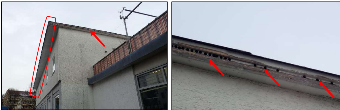
Abbildung 10: Gebäude „Hans-Stangenberger-Straße 41“ - Spalten im Bereich der Dachkante (rote Markierung, linkes Bild) und Traufkantenkasten mit Löchern (rote Pfeile, linkes Bild) sowie einer Detailansicht (rechtes Bild).
