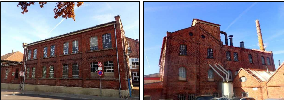
Abbildung 7: Denkmalgeschützte Firmengebäude der ELBE Schleiftechnik GmbH mit zahlreichen Nischen, Spalten und Schadstellen im Mauerwerk.
