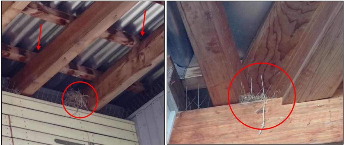
Abbildung 4: Ehemals genutzte Nester (rote Kreise) des Hausrotschwanzes sowie weitere mögliche Fortpflanzungs- und Ruhestätten auf den Querbalken (rote Pfeile).
