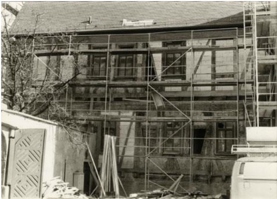
Ungewohnte Ansicht: während der Sanierungsarbeiten an der Rathausfassade ist das unter dem Putz verborgene Fachwerk zu sehen. Aufnahme 20.10.1979 durch Dipl. Ing. Brunner.
