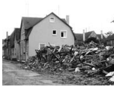
Abbruchstelle in der Ringstraße 8/10. Hier standen die seit 21. Dezember 1981 besetzten Häuser. Fotograf: Stefan Benning, Stadtarchiv Bietigheim-Bissingen.
